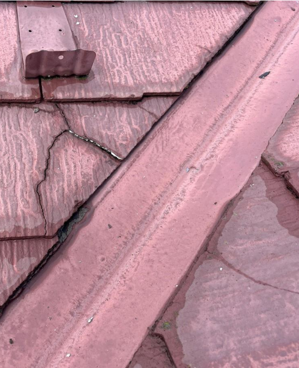
屋根 コロニアル クラック補修前
