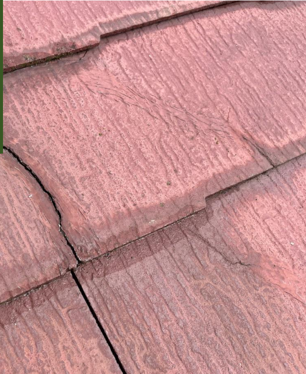
屋根 コロニアル クラック補修前
