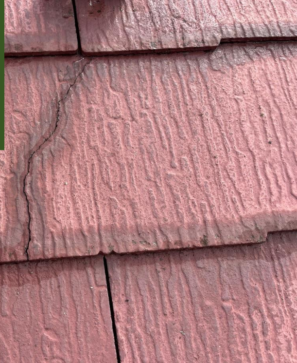
屋根 コロニアル クラック補修前
