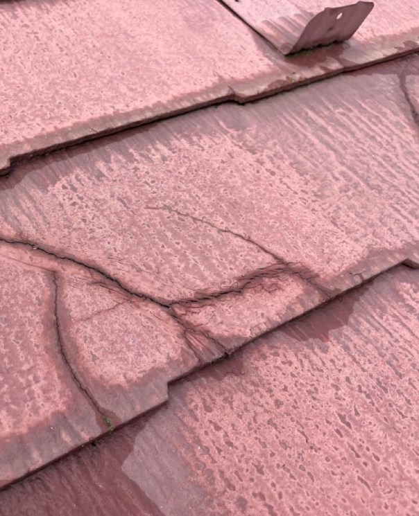
屋根 コロニアル クラック補修前
